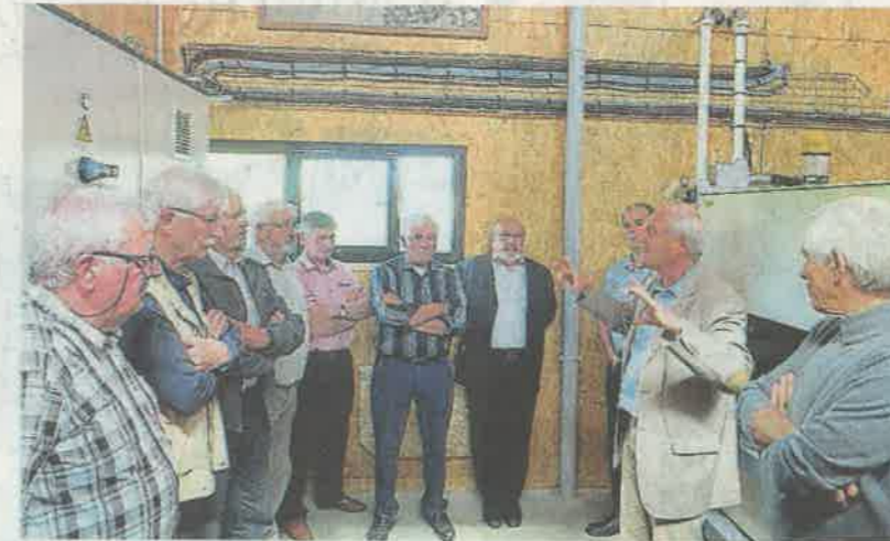
À l'intérieur du local technique, Hervé de Villepin, directeur du SAH (Directions départementales des territoires et de la mer) explique le fonctionnement du système et sa gestion à distance, grâce à des sondes et des logiciels adaptés.
