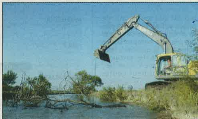
À l'aide d'une pelleteuse, le personnel du SAH a pu retirer des arbres entiers de la rivière
