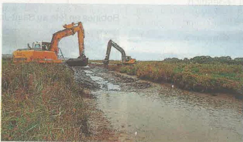
Des travaux de curage du Boivre ont été menés par le syndicat d'aménagement hydraulique.
